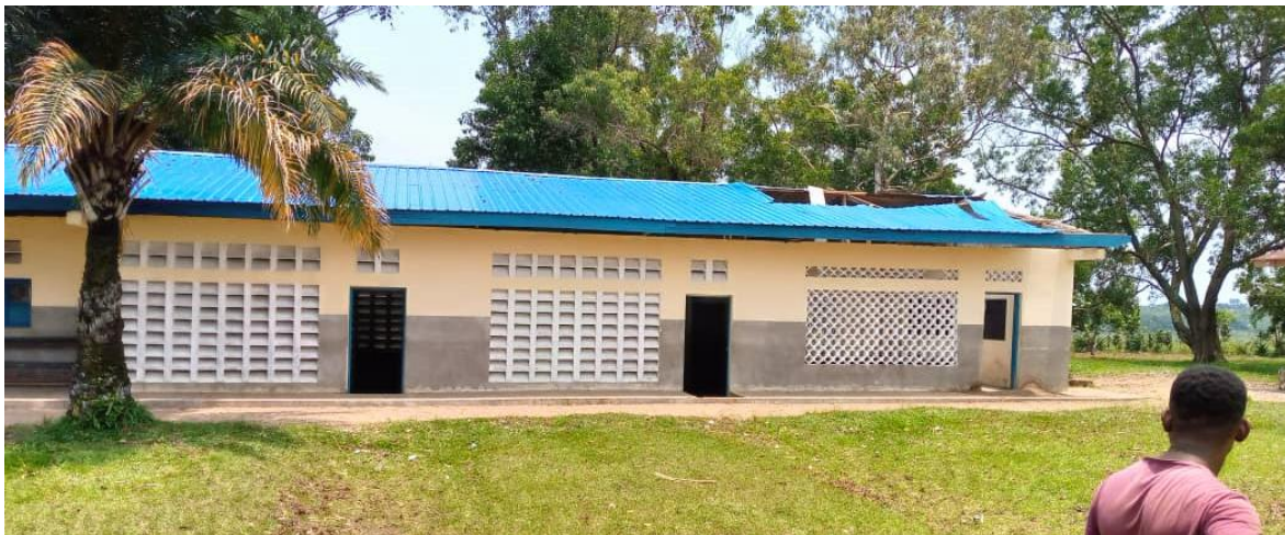
Abbildung 6: Durch Sturm geschädigtes Gebäude der Sekundarstufe in Tumikia
